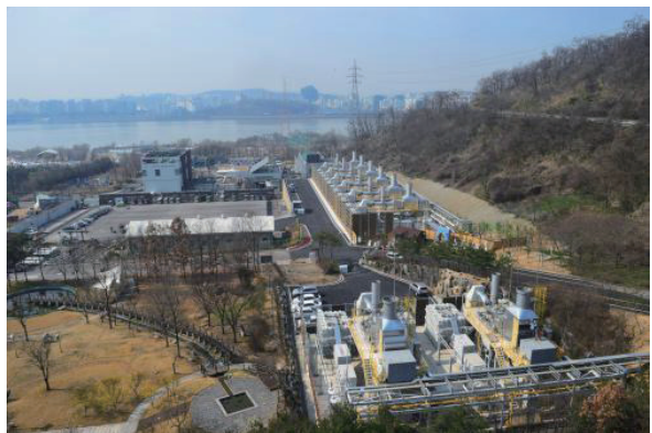
연료전지 발전소 노을 그린에너지 전경
