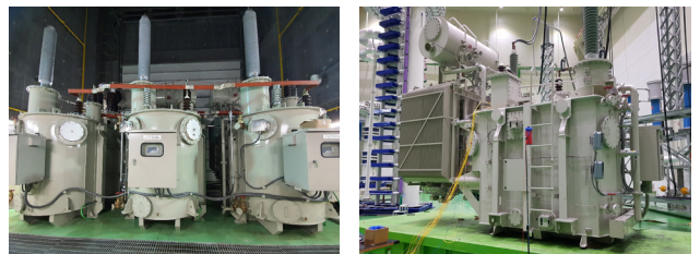
그림 3 안면변전소에 설치된 1단계 154kV 저손실 변압기(좌)와 2단계 154kV 고효율 변압기 시제품(우)
