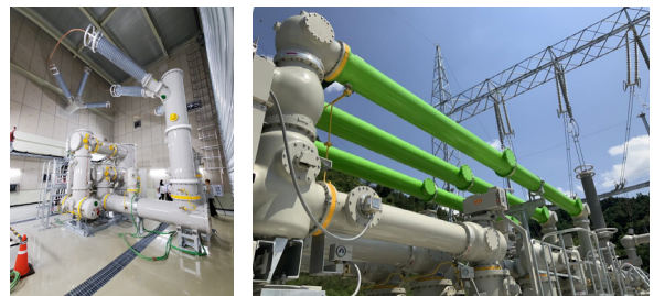
그림 1 왕곡변전소에서 실증중인 170kV Eco GIS(좌)와 고령변전소에 설치된 362kV GIB(우)
