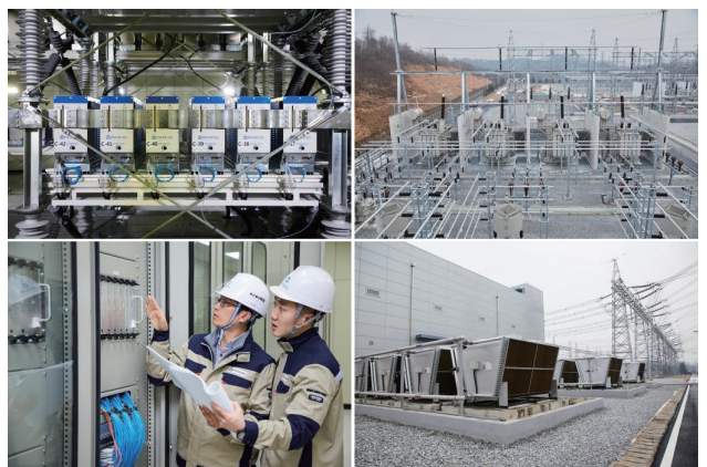
그림 8 신영주 400MVar MMC STATCOM 및 사이트 전경
