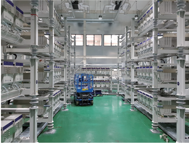
그림 3 20MW MMC HVDC 밸브실
